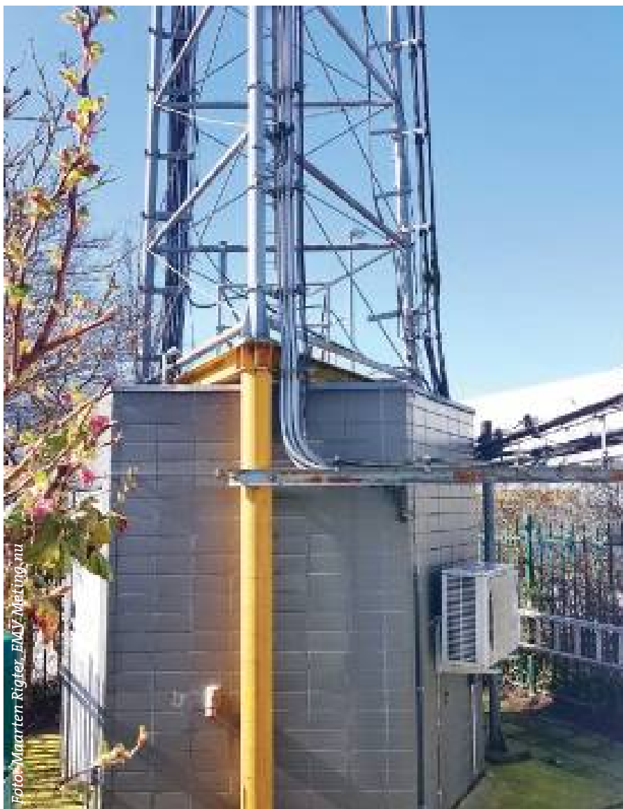
Tekenend voor het grote stroomverbruik zijn de dikke kabels die naar de antennes leiden en de airconditioners, die hier en daar aan ruimtes met regelapparatuur zijn vastgemaakt.
